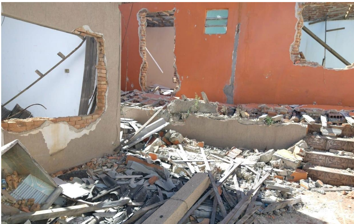
Laudo emitido para queda de laje, na Rua Senador Filinto Muller, com vítima fatal
